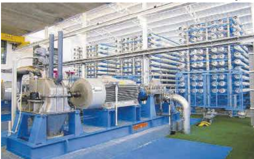
Desaladora de Santa Eulària.
