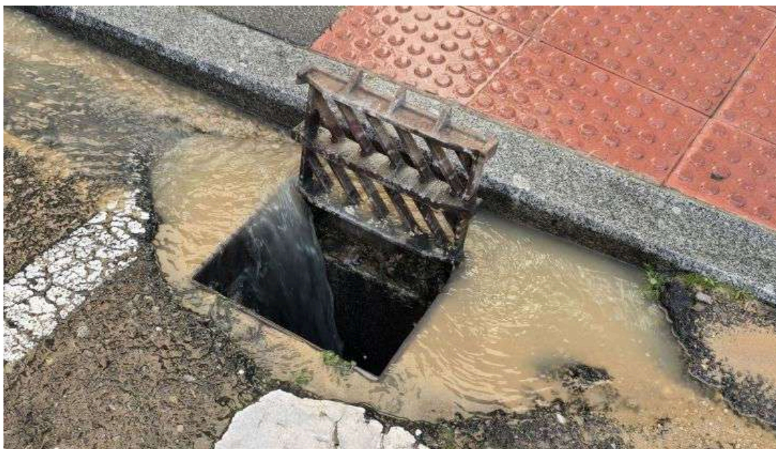
Reventón en el Camino de las Aguas con la presencia de la Policía Local
