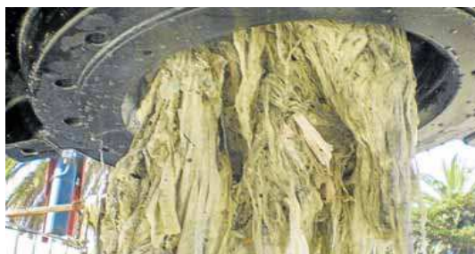
El cúmulo de residuos que atascó el colector de Bezana. DM
